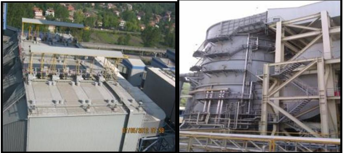
Şekil V.2.1.7. Absorber Dıştan Görünümleri
